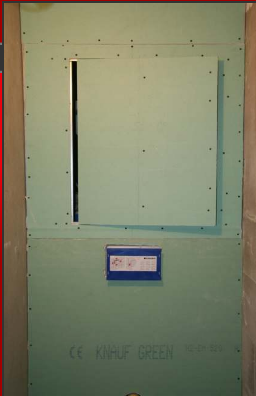
Kontrola funkčnosti dvířek.
